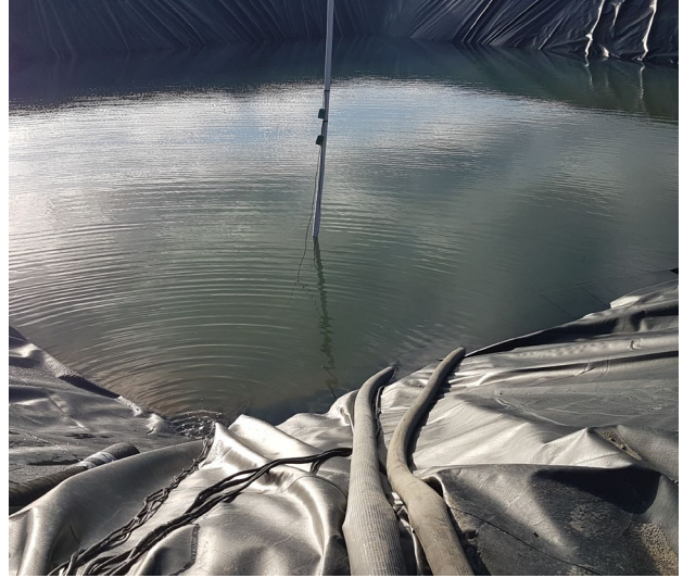
Photo 10 Effluent Pond inlet lines
